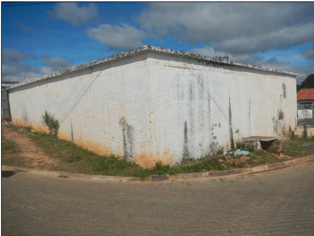
Figura 3-39 – Reservatório Alto do Gouveia.
