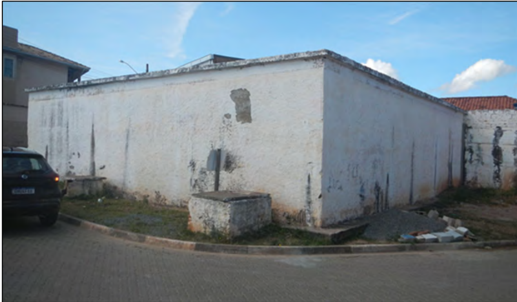
Figura 3-38 – Reservatório Alto do Gouveia.
