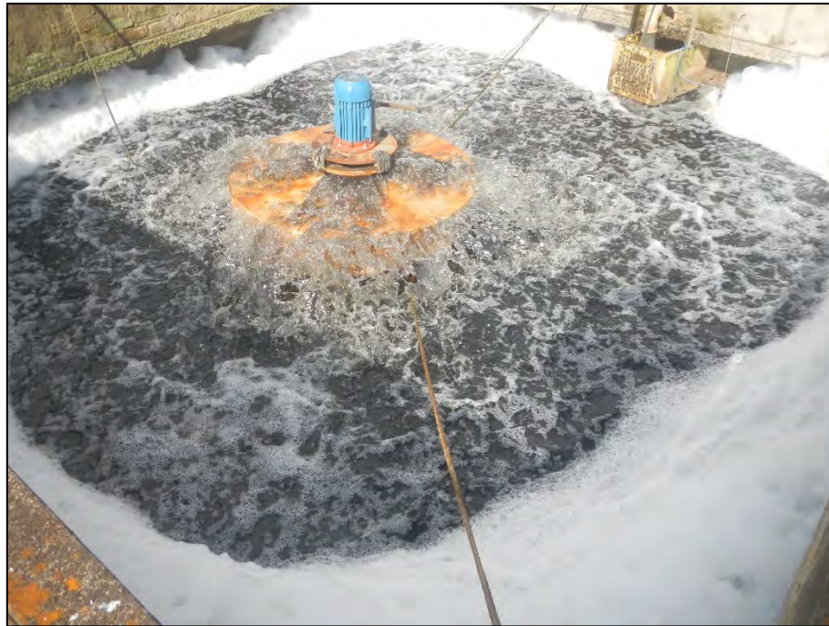
Figura 3-48 – ETE Campos de Cunha em Funcionamento.
