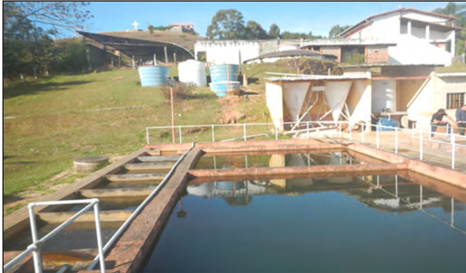
Figura 3-16 – Vista Geral – ETA Alto do Cruzeiro.
