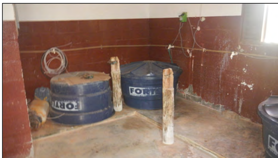
Figura 3-22 – Vista Interna da Casa de Produtos Químicos – ETA Campos de Cunha.
