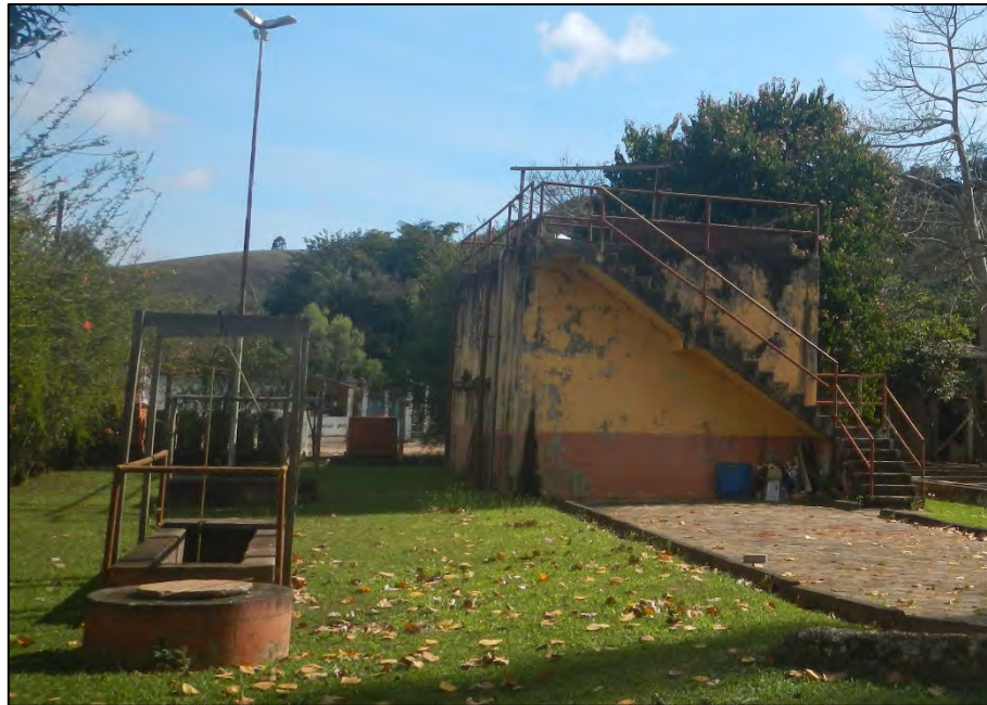
Figura 3-47 – Vista Geral da ETE Campos de Cunha.
