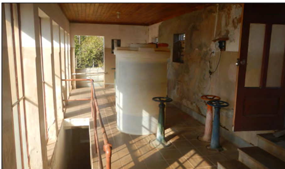
Figura 3-18 – Produtos Químicos Armazenados.
