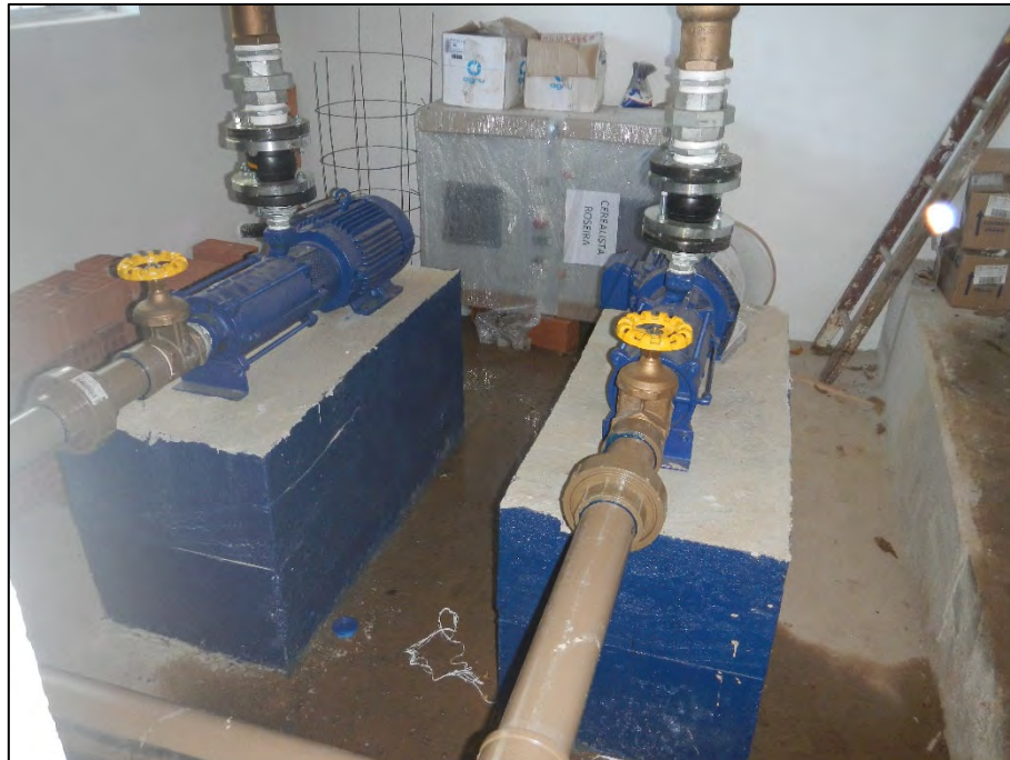
Figura 3-25 - Nova EEAT (pré-instalada por empreendedor de novo Loteamento).
