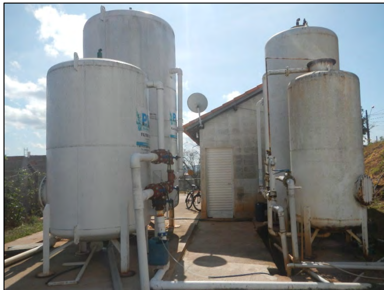
Figura 3-2 – Estação de Tratamento de Água (ETA) Parque Nova Cunha.
