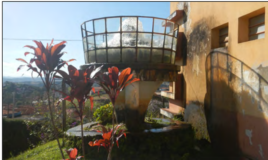
Figura 3-14 – Tanque de Aeração de Água Bruta – ETA Alto do Cruzeiro.
