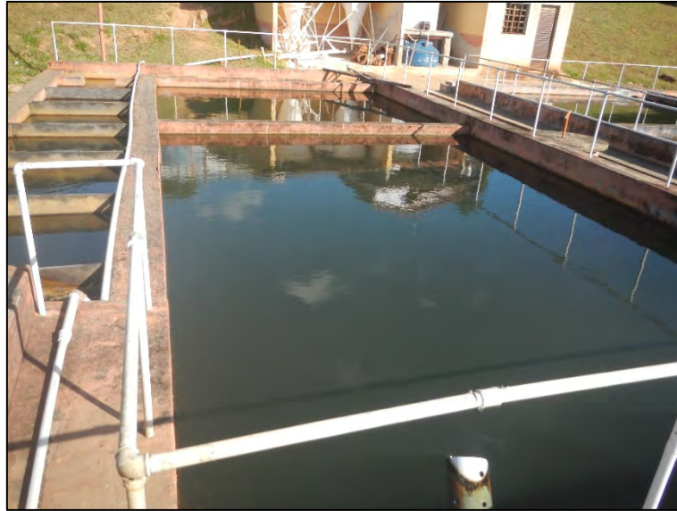
Figura 3-1 – Estação de Tratamento de Água (ETA) Alto do Cruzeiro/Central.
