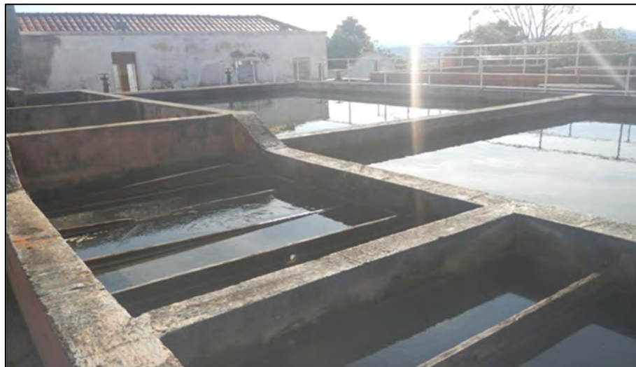
Figura 3-15 – Floculadores e Decantadores – ETA Alto do Cruzeiro.
