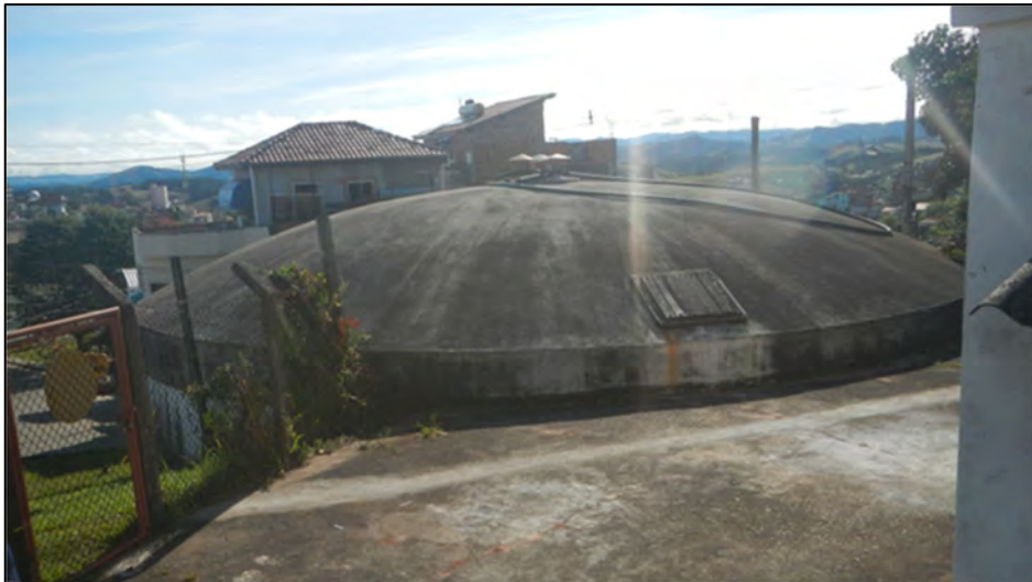
Figura 3-29 – Reservatório Alto do Cruzeiro 003/Central.
