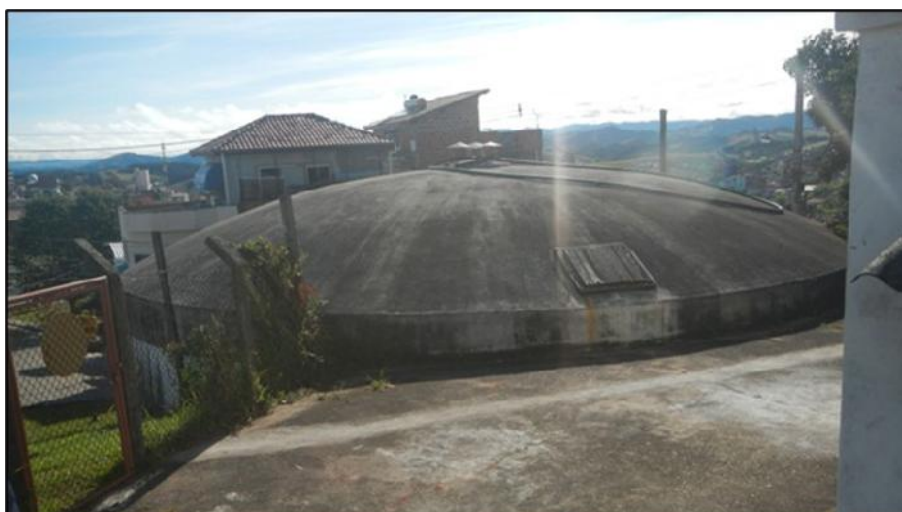
Figura 48 - Reservatório Alto do Cruzeiro 003/Central.
