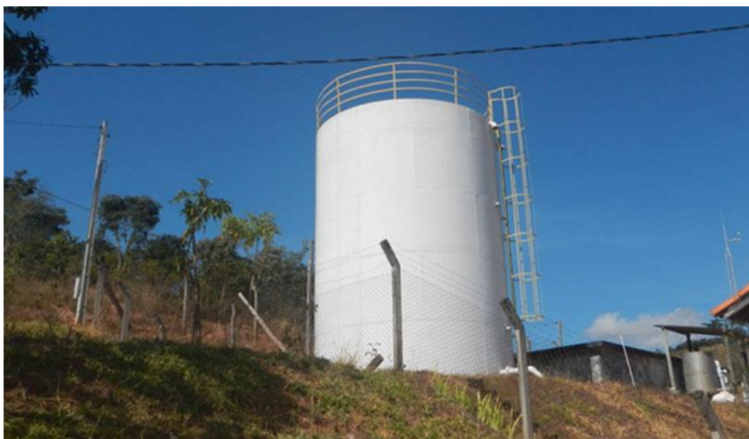
Figura 55 - Reservatório Parque Nova Cunha 002.
