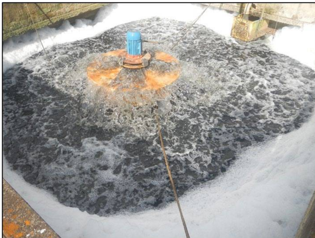
Figura 67 - ETE Campos de Cunha em Funcionamento.
