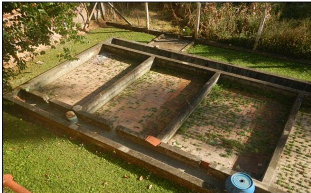
Figura 68 - Leito de Secagem do Lodo Gerado no Sistema.
