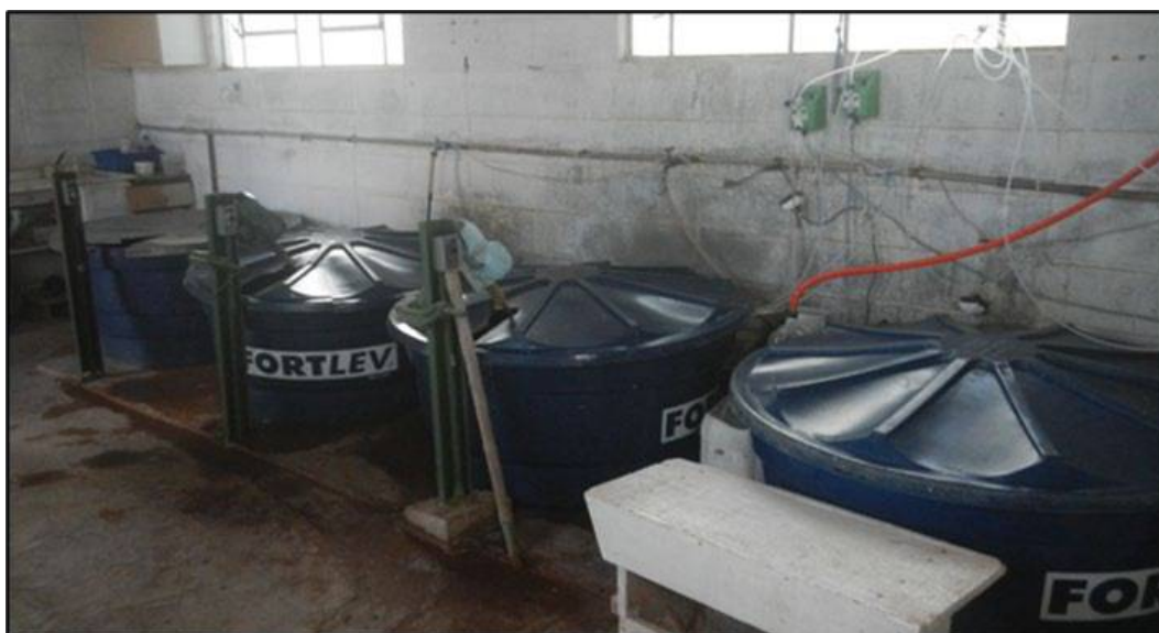
Figura 39 - Tanques de Preparo e Homogeneização de Produtos Químicos – ETA Parque Nova Cunha.
