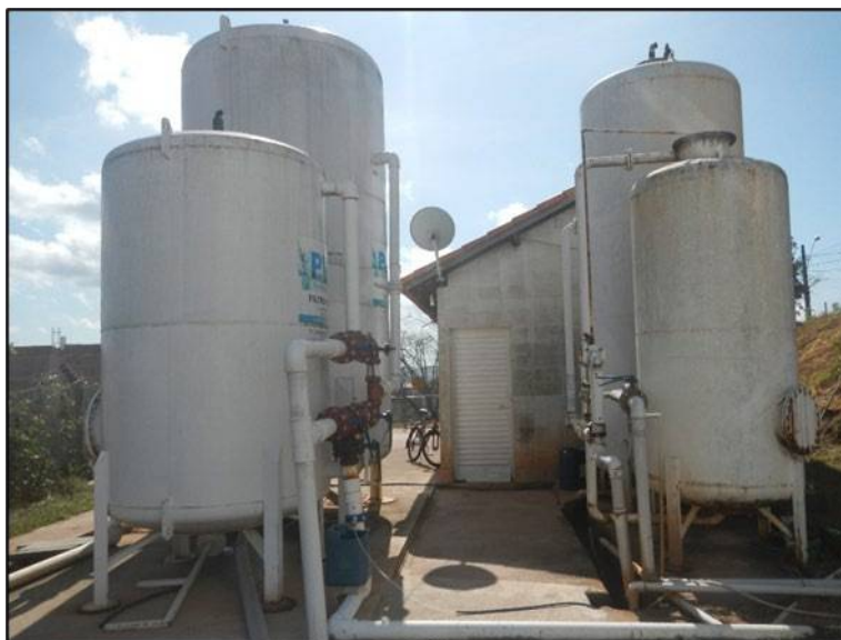
Figura 21 - Estação de Tratamento de Água (ETA) Parque Nova Cunha.
