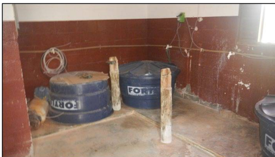
Figura 41 - Vista Interna da Casa de Produtos Químicos – ETA Campos de Cunha.
