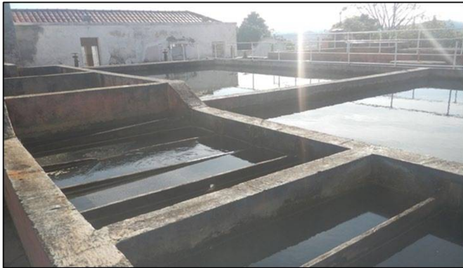
Figura 34 - Flocculadores e Decantadores – ETA Alto do Cruzeiro.
