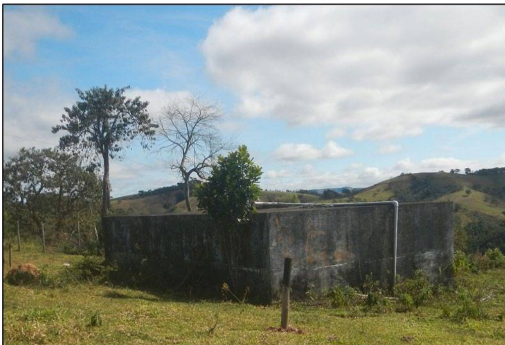
Figura 63 - Vista Geral do Reservatório Campos de Cunha 002.
