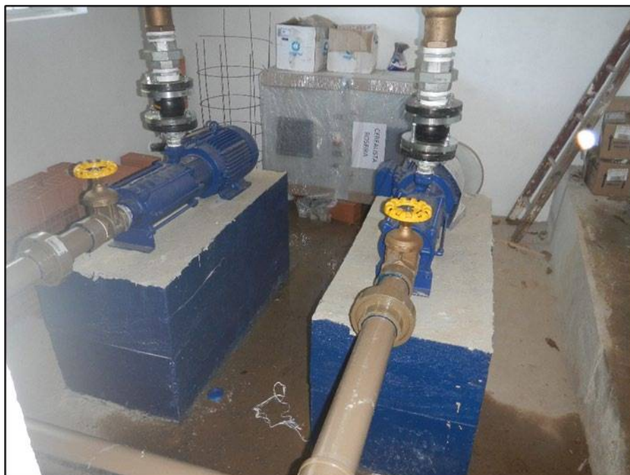
Figura 44 - Nova EEAT (pré-instalada por empreendedor de novo Loteamento).
