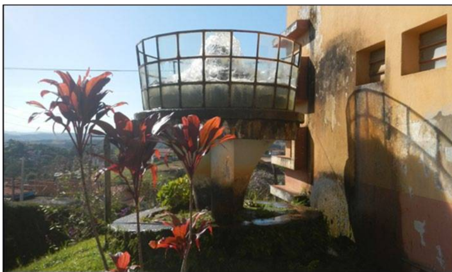
Figura 33 - Tanque de Aeração de Água Bruta – ETA Alto do Cruzeiro.
